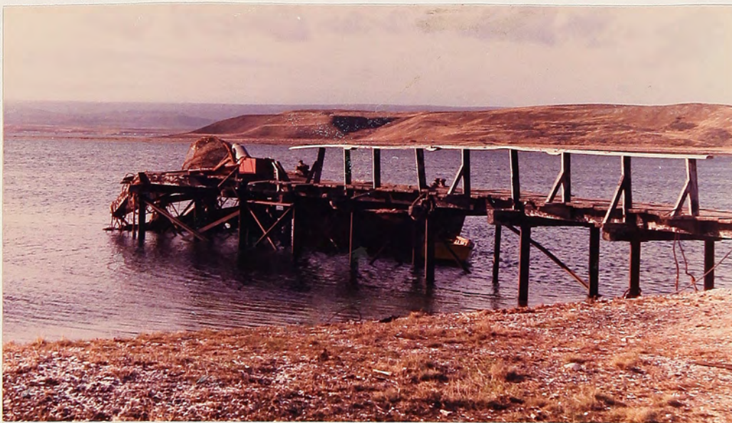
Figura 10 : Muelle fiscal de Bahia Chilota. Notese el mal estado general, sin disponibilidad de agua potable ni electricidad.
